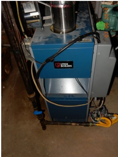
HVAC unit mfg. date(s) - 2014
