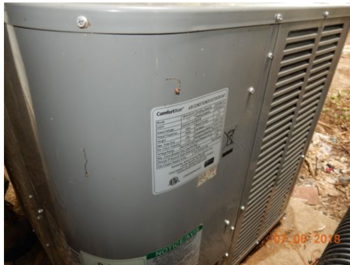
HVAC unit mfg. date(s) - 2014 AC unit
