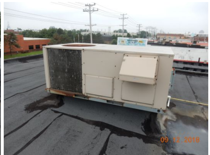
HVAC unit mfg. date(s) - 2001
