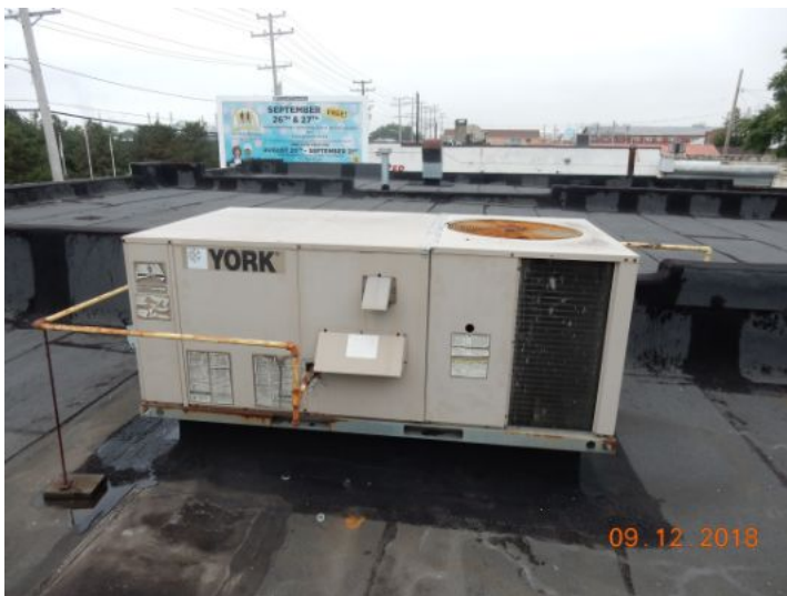
HVAC unit mfg. date(s) - 2001
