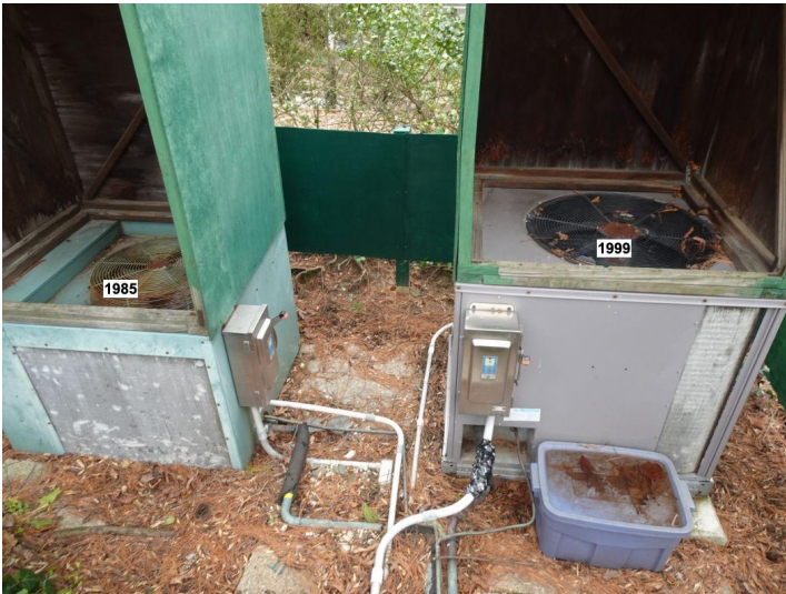
HVAC unit mfg. date(s) - 1985, 1999
