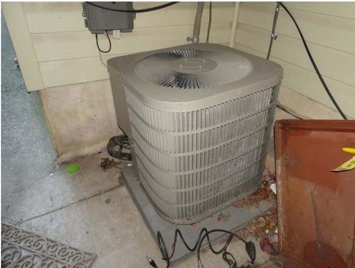
HVAC unit mfg. date(s) - 2004
