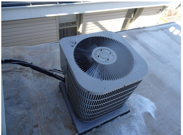
HVAC unit mfg. date(s) - 2004
