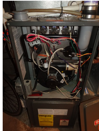
HVAC unit mfg. date(s) - 2004
